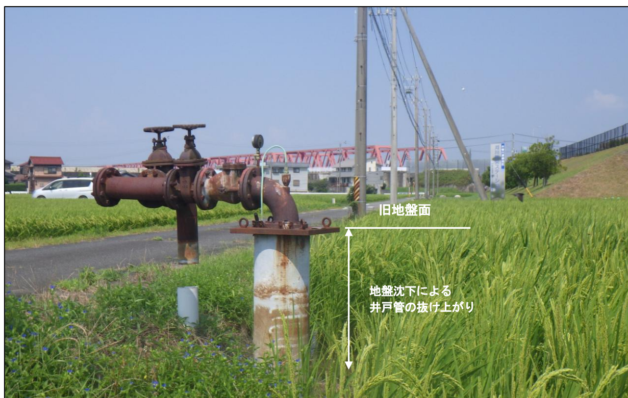
写真－1 三重県桑名郡木曾岬町の井戸管の抜け上がり状況（令和8年7月撮影） ※ 近傍の水準点(C35－9)における累積沈下量：124cm（昭和36年～令和7年）
