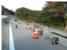
【図③：道路陥没状況】
