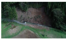
【写真⑩：被災箇所（近景）】
