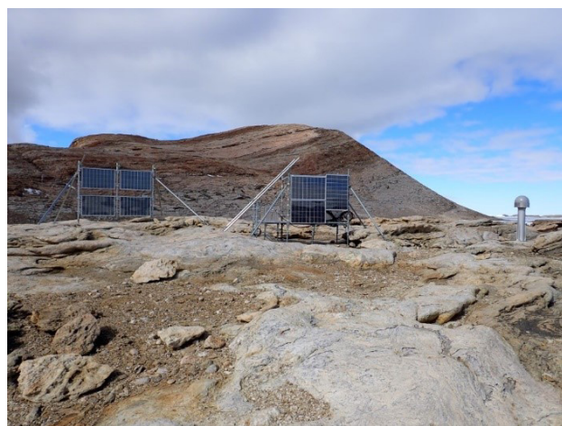
改造後のGNSS連続観測点 (写真左：今回増設したソーラーパネル架台)
