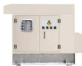
非常用発電設備
