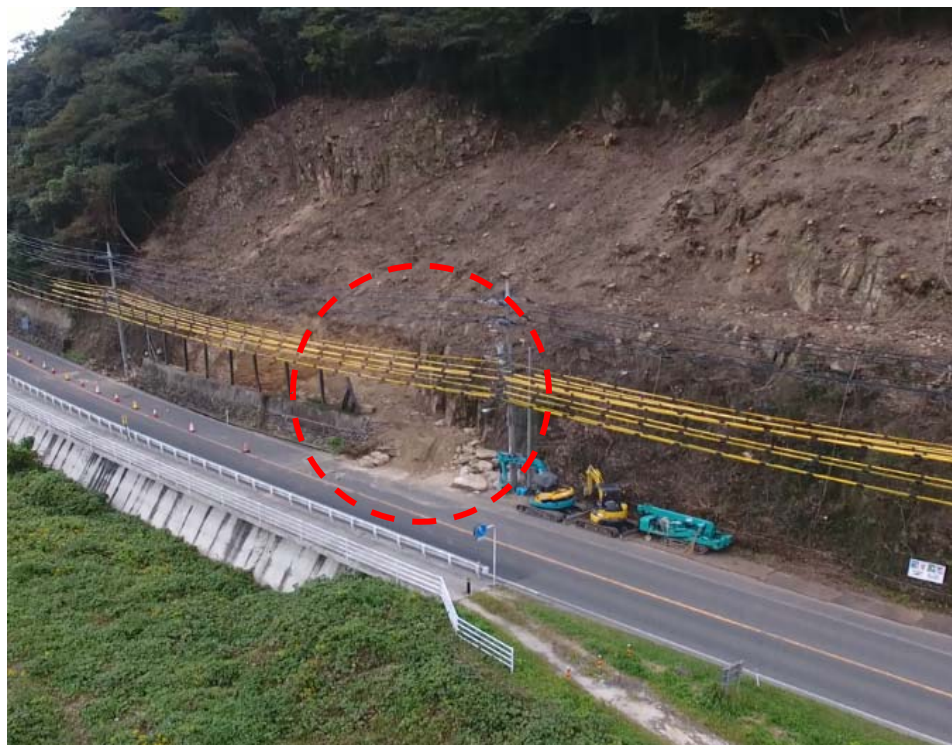
鳥取県倉吉市大原の落石箇所
