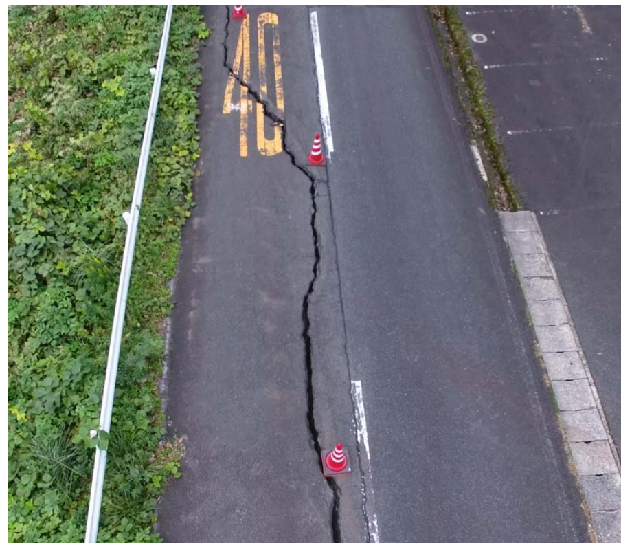
鳥取県東伯郡三朝町三朝の道路亀裂箇所
