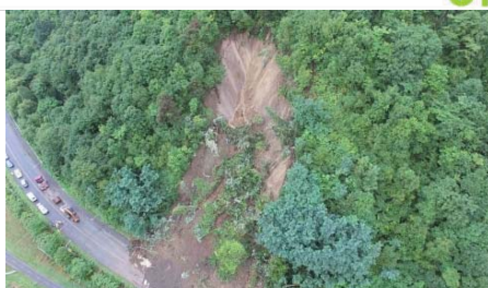
UAVによる斜面崩壊状況の把握 （平成28年8月22日砂川市焼山）
