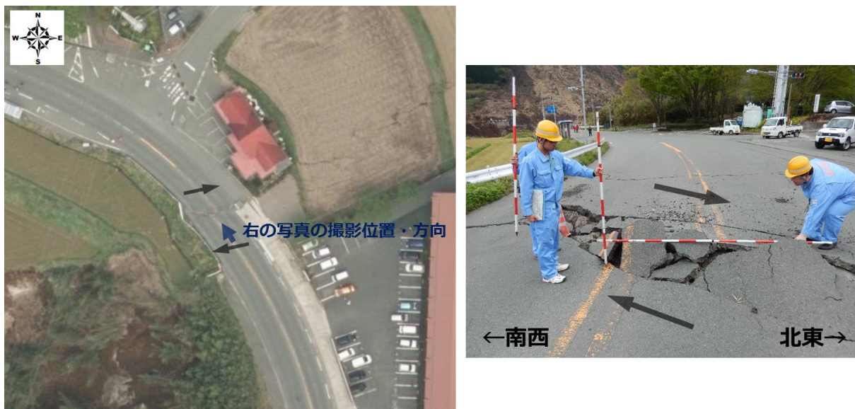
図-2 航空写真で確認できる右横ずれの亀裂（左）と同地点の現地写真（右）。右の現地写真では、道路のセンターラインが約 1.2m 右横ずれしているのが分かります（赤白ボールの 1 目盛は 20cm）。
