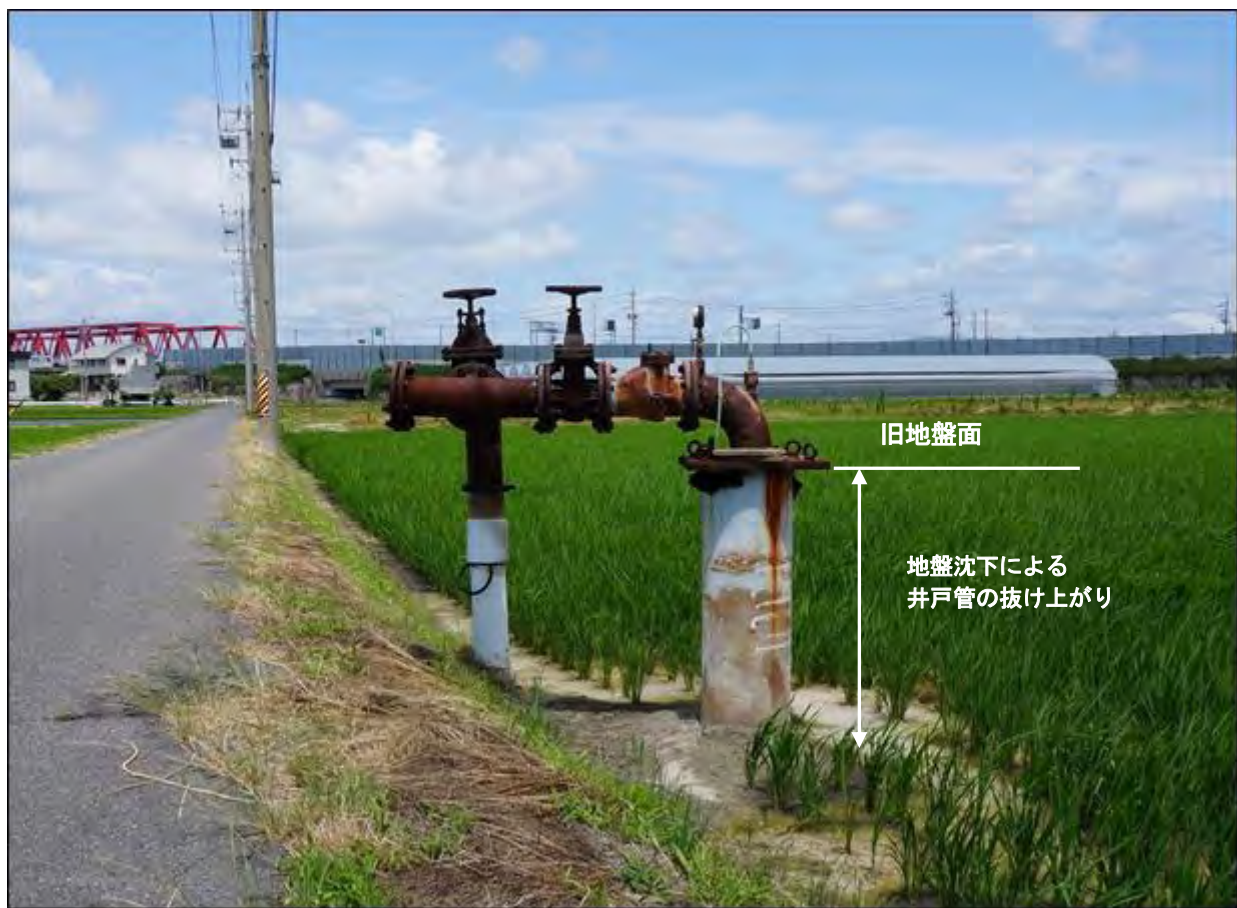
写真-1 三重県桑名郡木曾岬町の井戸の抜け上がり状況（平成26年6月撮影） ※ 近傍の水準点(C35-9)における累積沈下量：117cm(昭和36年～平成26年)
