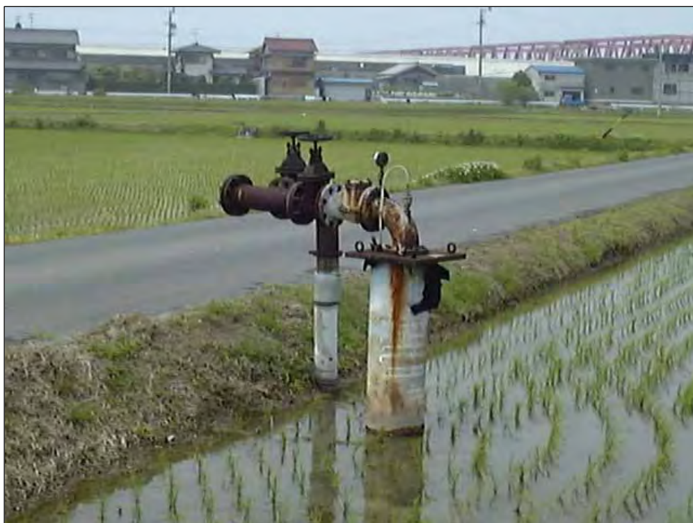
写真－1 三重県桑名郡木曾岬町の井戸の抜け上がり状況（平成15年5月撮影） ※ 近傍の水準点(C35－9)における累積沈下量：115cm
