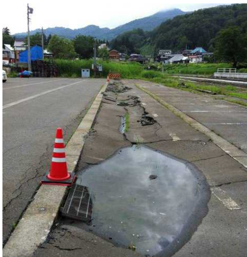
写真-9 JR 森宮野原駅の液状化被害。埋設管等の埋戻し部分が液状化により沈下している。
