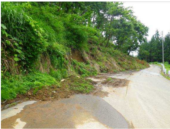
写真-14 青倉地区集落背後の山間部道路に見られた地すべり。道路法面が崩壊して、道路を半分以上塞いでいる。
