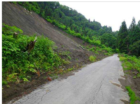
写真-18 雪坪地区と小滝地区を結ぶ林道に見られた斜面崩壊（写真撮影位置は図-8 参照）。調査時点で道路上の崩壊土砂は片付けられていた。表層崩壊だが、雪崩防止柵ごと崩落していた。
