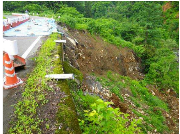
写真-22 当部地区の県道 507 号線沿いで見られた斜面崩壊 (写真撮影位置は図-8 参照)。崩壊により路肩が崩落し、路面に変状が生じていた。
