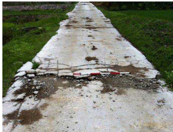
写真-3 農道における重力性変状による路面の圧縮性亀裂（大井平地区）。路面の舗装部分（コンクリート）が写真奥（南側）から手前（北側）に向かって移動している。
