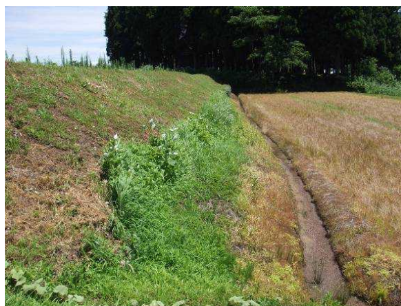
写真-4 水田における重力性変状による畦（土手）のはらみ出し（亀岡地区）。写真左が北方向。
