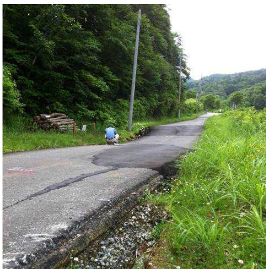
写真-24 大巖寺牧場西側の道路に見られた段差 (写真撮影位置は図-10 参照)。写真奥 (南東方向) に見える補修痕部分で 50cm 程度の段差があり、写真手前側が沈下している (沈下部分が盛土)。
