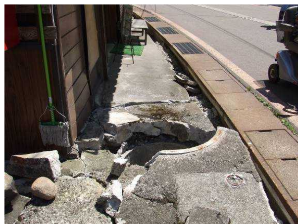
写真-8 家屋土台部の開口亀裂（森地区）
