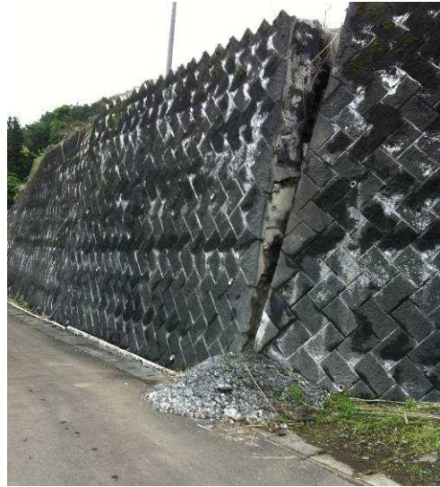
写真-16 擁壁のはらみ出し（横倉地区）
