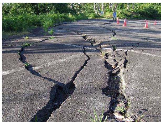
写真-25 大巖寺高原キャンプ場の駐車場で見られた開口亀裂 (写真撮影位置は図-10 参照)。駐車場の北側 (写真左側) が谷斜面になっているが、亀裂の北側が隆起 (または南側が沈降) している。
