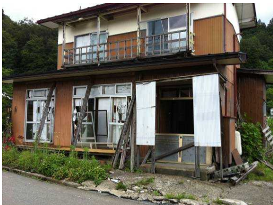
写真-15 被災家屋（横倉地区）
