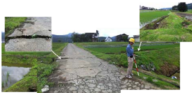
写真-7 松多ほか（2011a, b）が報告した道路変状（亀岡地区）。写真奥が北方向。
