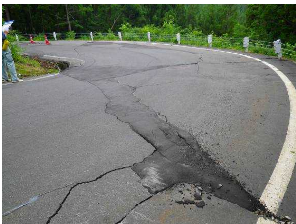
写真-21 天池地区東方の道路 (県道 407 号線) に見られた変状 (写真撮影位置は図-8 参照)。尾根部を回り込むカーブ部分で、尾根が地すべりのために写真右奥側 (西側) に変動したことにより道路に開口亀裂が発生した模様。
