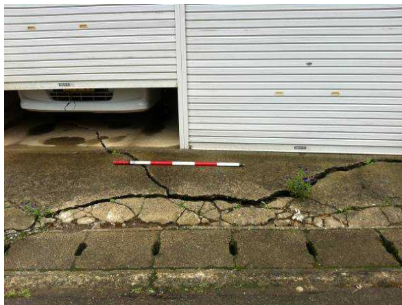
写真-2 車庫土台部の開口亀裂（大井平地区）
