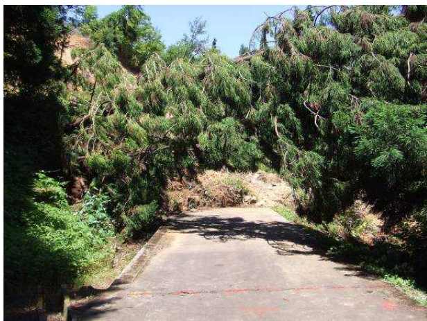
写真-17 雪坪地区と小滝地区を結ぶ林道に見られた地すべり（写真撮影位置は図-8 参照）。写真の左側（西側）から右側（東側）へ崩落しており、道路が完全に寸断されていた。
