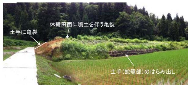
写真-5 重力性変状（亀裂、はらみ出し）が見られた盛土状の休耕田（大井平地区）。休耕田面には亀裂に沿って噴土が確認された。写真奥が南方向。
