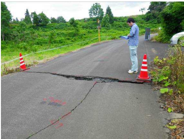
写真-20 堀切地区西部の農道に見られた亀裂 (写真撮影位置は図-8 参照)。亀裂の手前側 (西側) が盛土になっており、盛土部が沈下したことによる。
