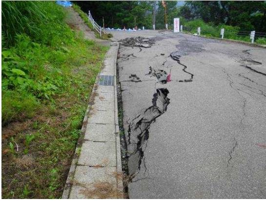
写真-13 青倉地区集落背後の山間部道路に見られた変状。道路盛土部が写真左側から右側方向に変動し、路面に開口亀裂が発生している。
