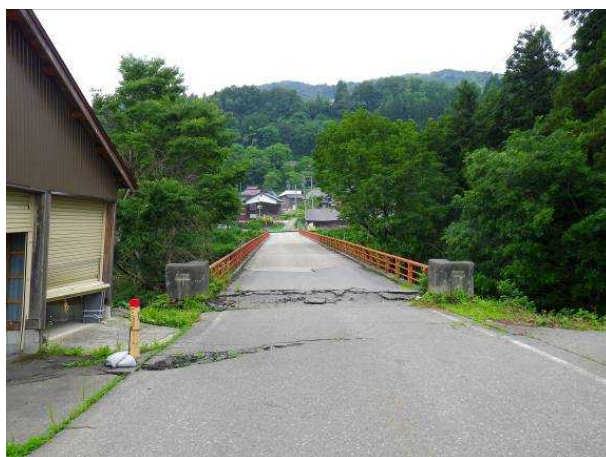
写真-12 橋梁接続部の段差（青倉地区）
