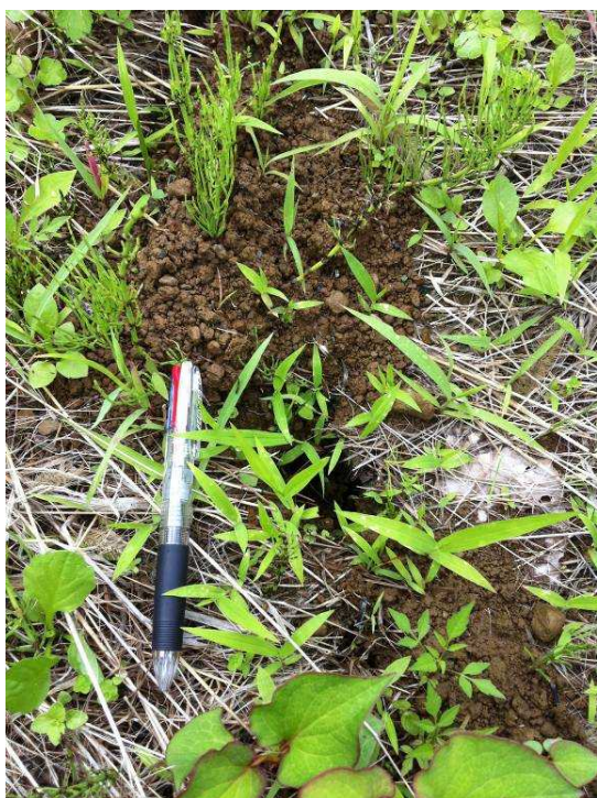
写真-6 休耕田面で見られた亀裂と噴土（大井平地区）
