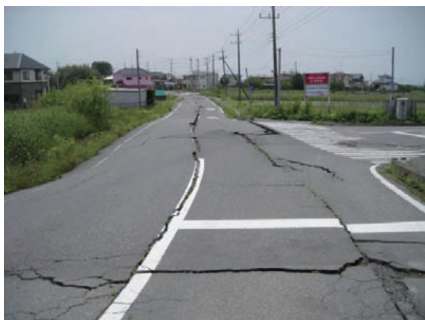
写真-3 道路上の亀裂や地波現象
