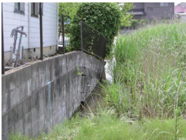
写真-4 盛土が南西側に傾き、家屋も傾いている
