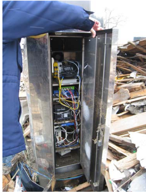
写真-4 電子基準点 020906（田老）収納箱内
