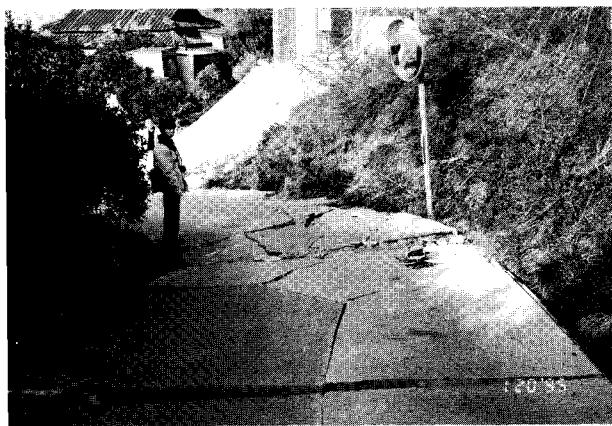
写真-8 北淡町野島轟木の断層亀裂
