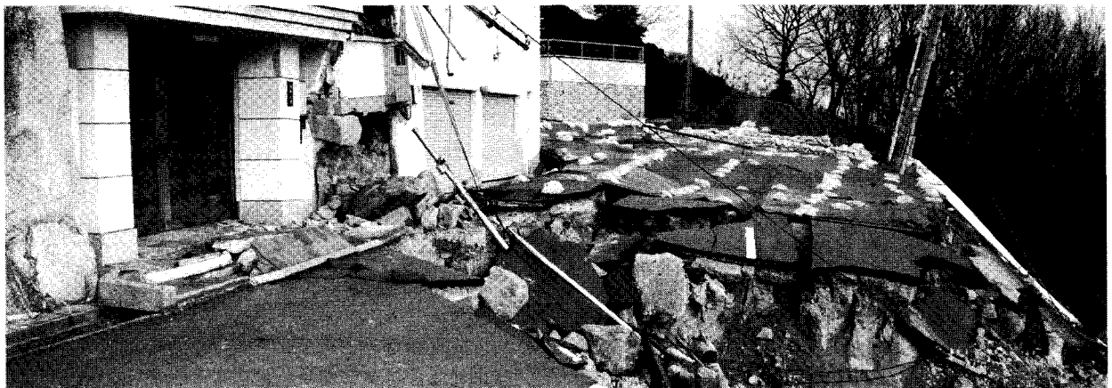
写真－2 東灘区西岡本の斜面崩壊と建物の被害状況
