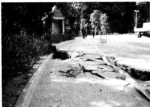
写真-2 水準点の北側に生じた亀裂（玉野総合コンサルタント株式会社提供）
