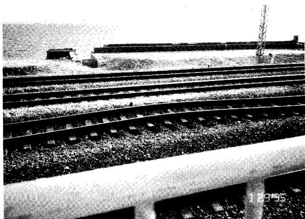
写真-1 海側（南側）に膨らんだレール
