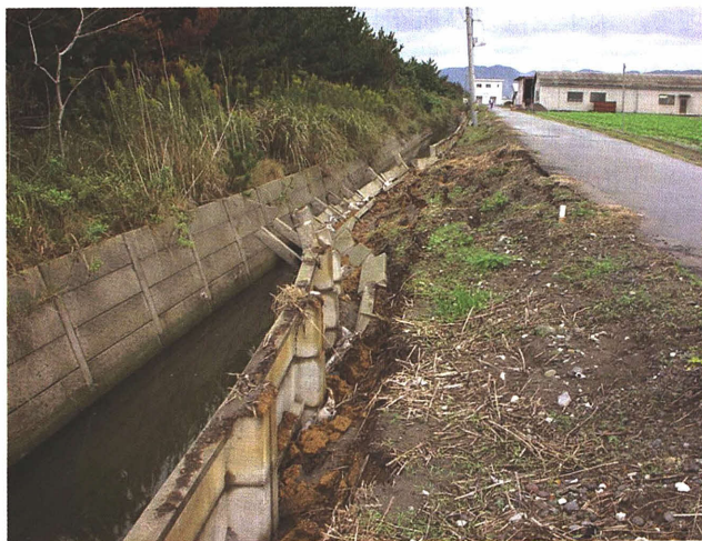
写真-10 排水路よう壁の損壊(E-2)
