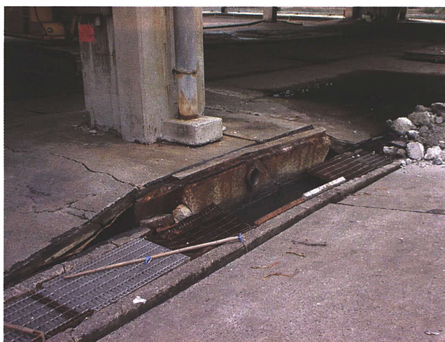
写真－7 抜けあがった上屋の支柱(B-3)
