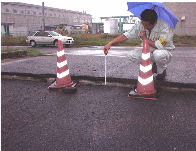
写真－8 暗渠部分の抜け上がり(D－1)
