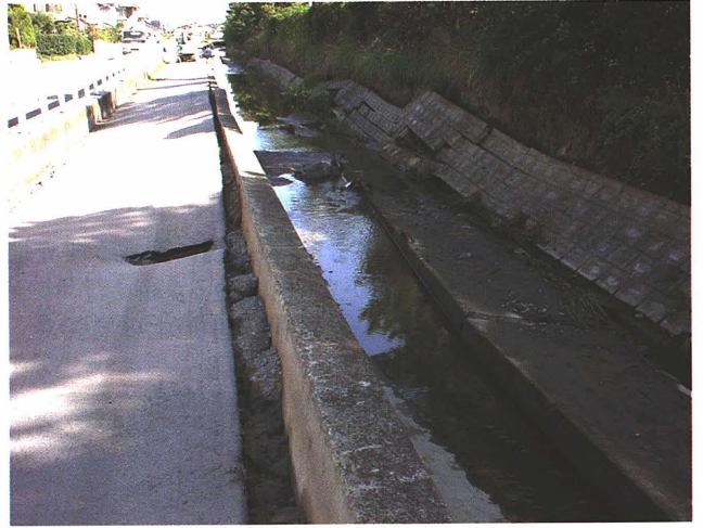
写真-14 排水路よう壁の倒壊と歩道の陥没 (G-1)
