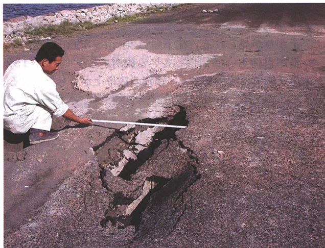
写真-20 堤外地での噴砂と陥没
