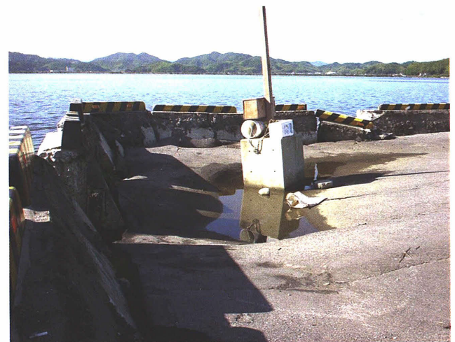
写真-16 米子港岸壁の陥没 (G-3)
