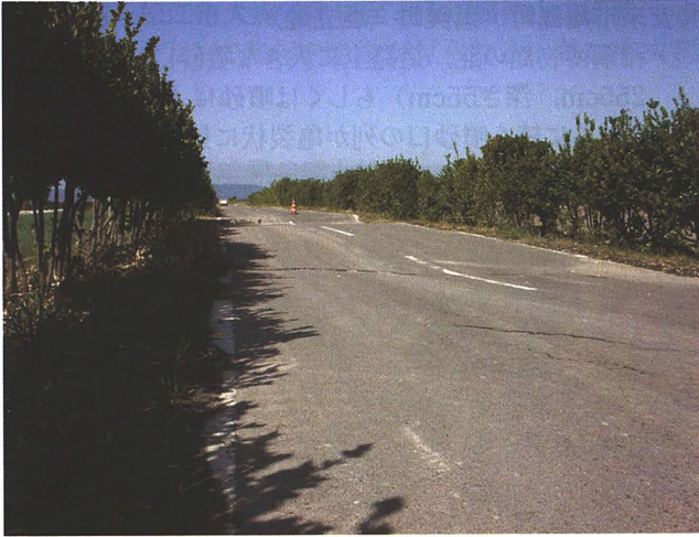
写真-13 道路の陥没と亀裂 (F-2)
