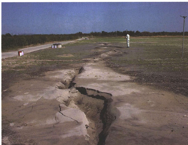
写真-12 巨大な亀裂と噴砂
