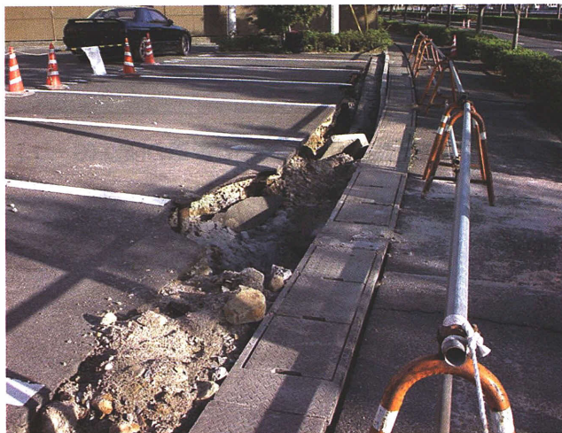
写真-17 団地内駐車場の亀裂と陥没
