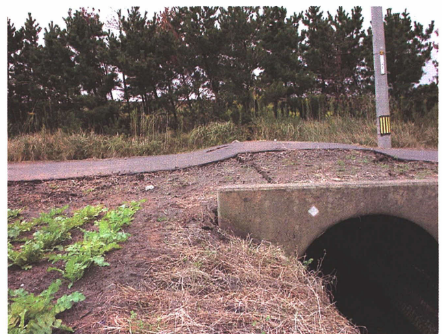
写真－9 管渠部の抜け上がり(E－1)
