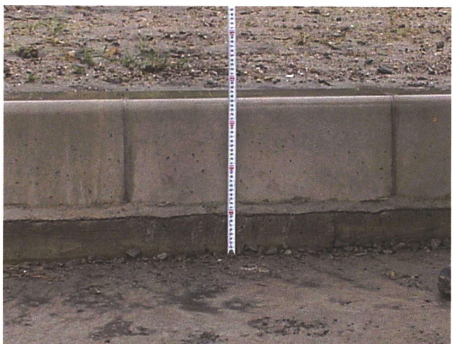
写真－2 道路縁石の抜け上がり(A-2)
