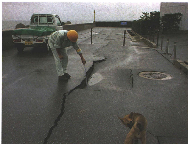
写真－3 外周道路の亀裂と陥没(A-3)
