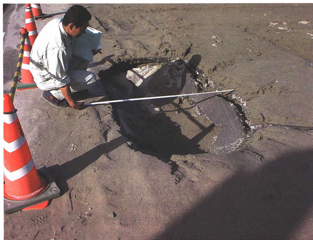
写真-19 巨大な噴砂口
