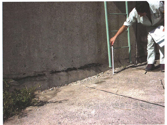
写真-15 護岸部の抜け上がり (G-2)
