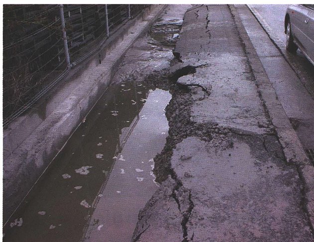
写真－5 道路側溝からの噴砂(B-1)
