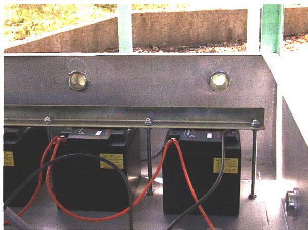
写真-8 電池室内のバッテリー
