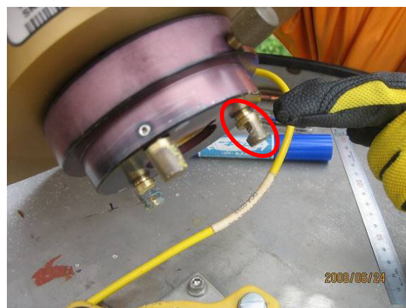
写真－4 回転台座留め金の緩み
