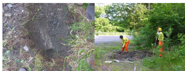
写真-2 BM. 8 (左:故障点を確認 右:基準点搜索中)
