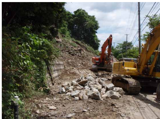
写真-6 国道342号通行止め区間 (BM.7-No.4)
