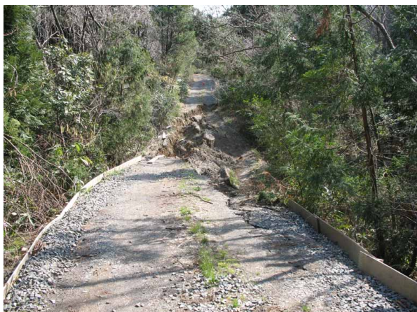
写真-1 崩壊した林道
