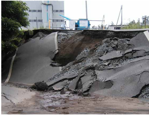
図-18 段差 2m以上の亀裂（図-12 の d1, 図-20 の赤丸）
