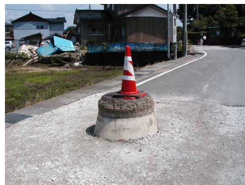
図-23 マンホールの抜け上がり（図-12 の f3）
