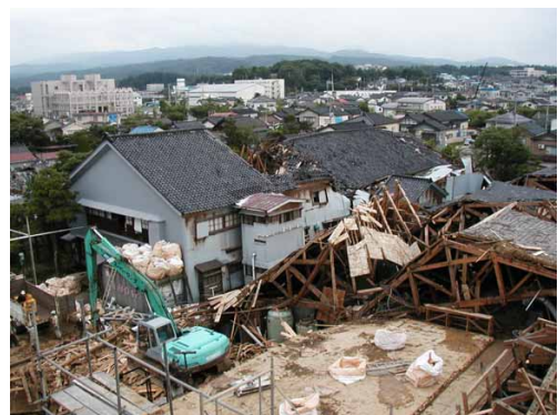
図－10 木造蔵小屋の壊滅的倒壊（図－3のb1）
