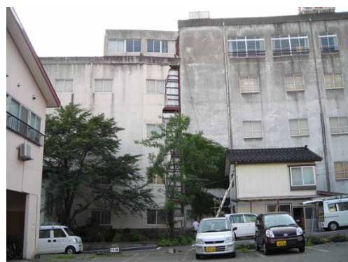
図－6 建物の傾き（図－3のa4）
