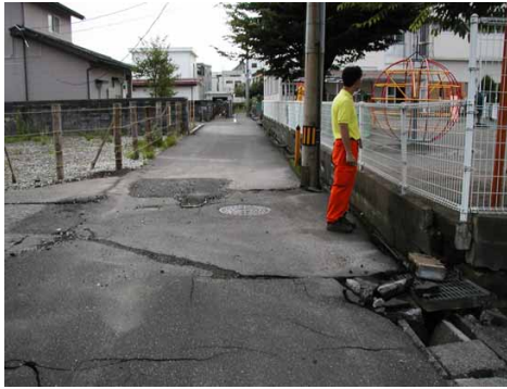
図－7 斜面下部の圧縮変形（図－3のa5）
