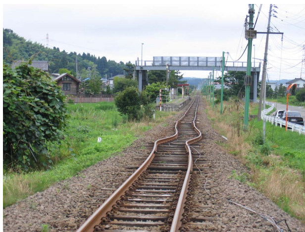
写真-3 JR 越後線刈羽駅南方のレールの変形
