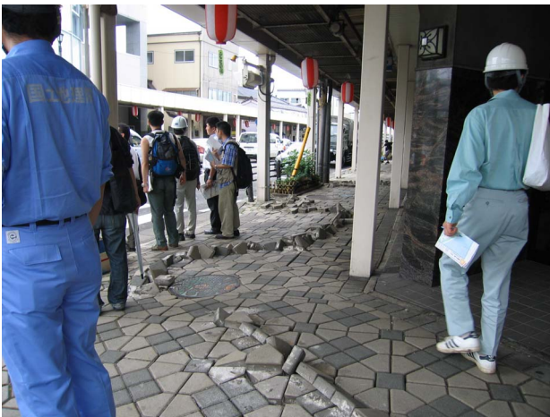
写真－7 歩道敷石の破損
