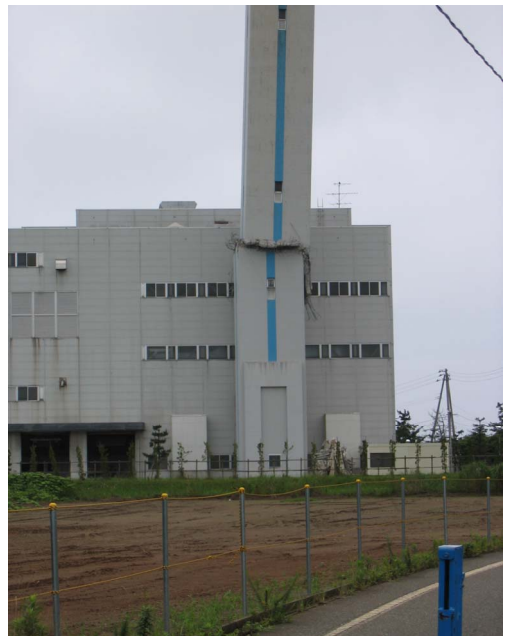
写真-2 煙突の座屈（柏崎クリーンセンター）
