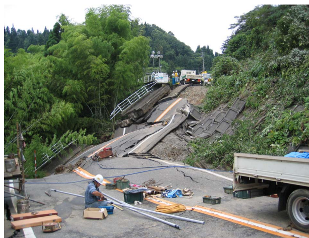
写真-5 長岡市大積町（国道8号線）の地すべり
