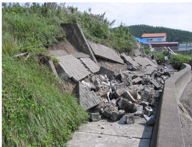
写真-6 堤防周辺の法面崩壊
