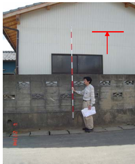
写真－10 住宅の壁の浸水痕
