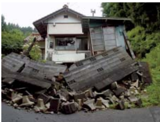
写真一14 旭山撓曲に近い盛り土・家屋の崩壊(図一6、地点③)
