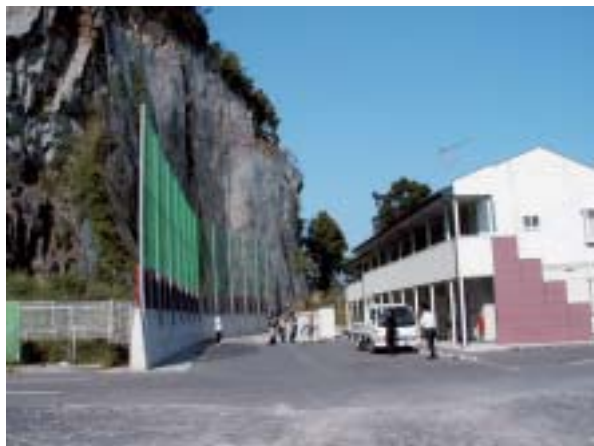
写真-12 落石現場の切り土斜面の状況
