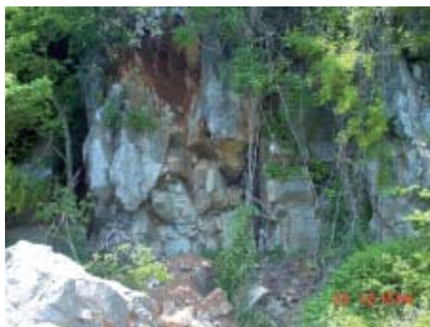
写真ー11 多数の亀裂を生じた崖の表面
