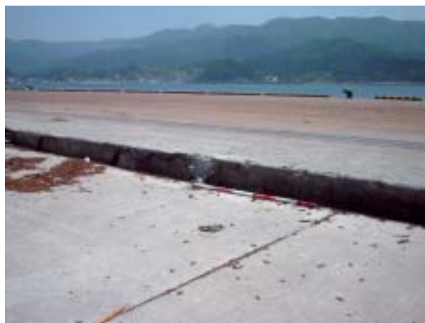
写真-9 地震による段差の発生
