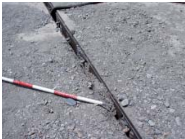
写真-8 液状化による噴砂
