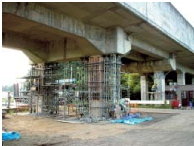
写真-7 新幹線橋脚の損傷の状況
