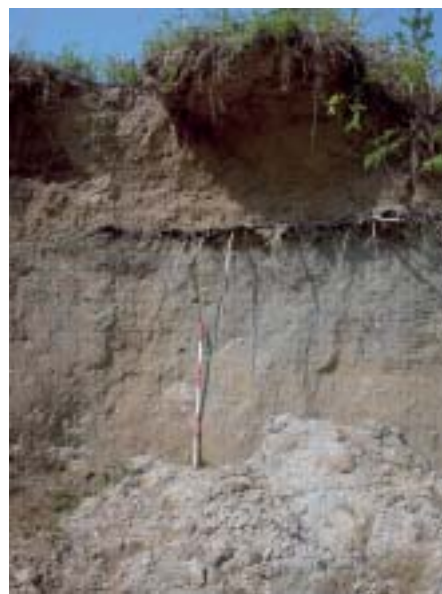
写真－4 崩壊頂部の地質
