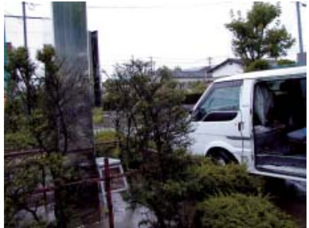
写真－2 電子基準点「矢本」。自動車から電源を取り、モデムを仮復旧（東北地方測量部）
