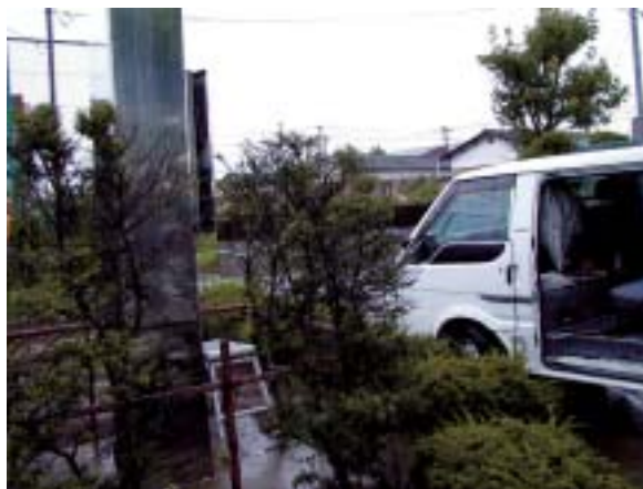
写真－2 作業車から100V電源を電子基準点に供給
