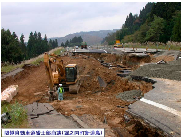
写真－1 関越自動車道盛土部崩壊
