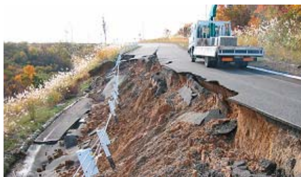
写真－5 崩落した道路（魚沼市）
