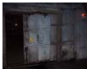
写真-10 気圧調整用鉄扉
