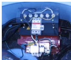
写真－15 耐雷トランス
