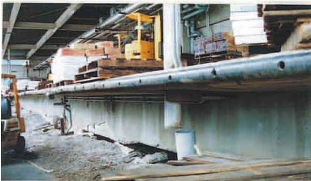
写真-5 抜け上がり
